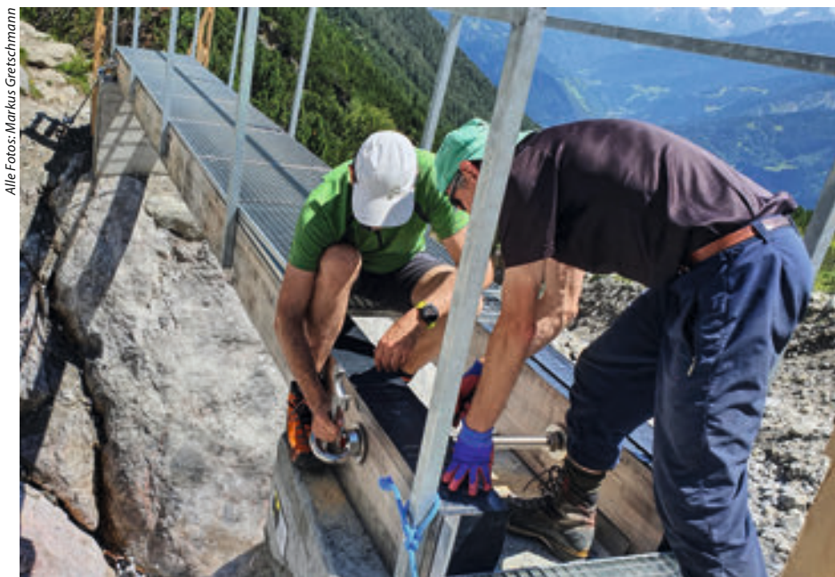
Markus Gretschmann und Klaus Szech bei der Sanierung der Brücke über den Gasillbach an der Augsburger Hütte.
